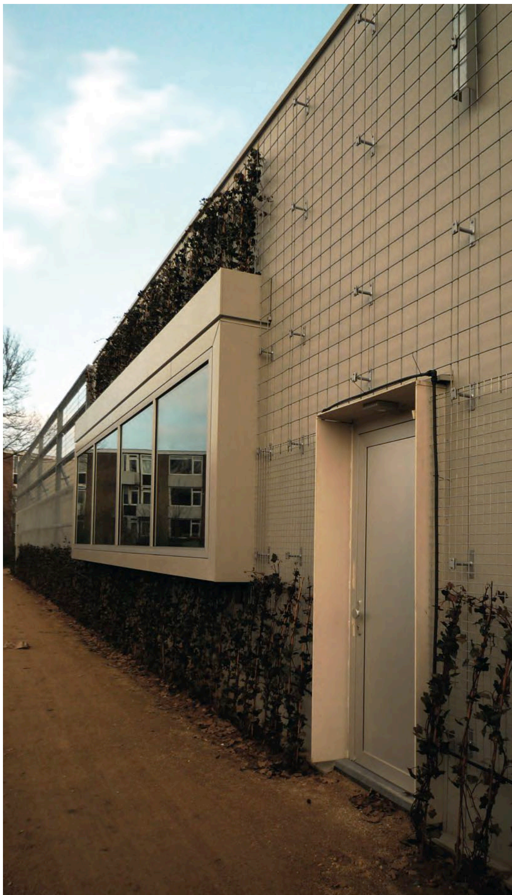
Een bewateringssysteem met opgevangen regenwater verzorgt het groen. Om koudebruggen te voorkomen is het wapeningsnet bevestigd op de koppelingen van de sandwichpanelen.
